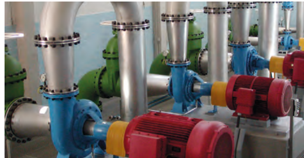
Die Pumpen der Wasserwerke Paderborn GmbH stellen tagtäglich frisches Trinkwasser bereit.
